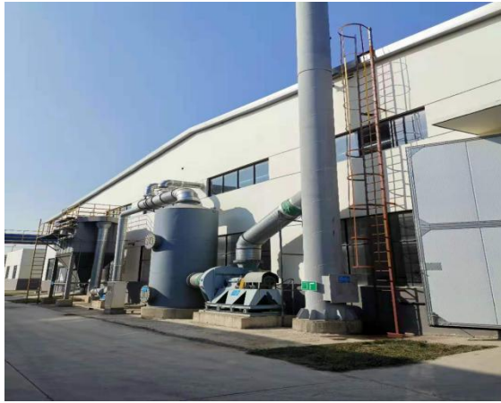
DA004 颗粒状活性炭预处理车间排气筒及处理装置
