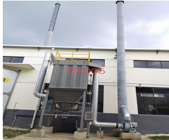
DA005 颗粒车间包装废气排气筒及处理装置
